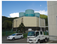
森地熱発電所 冷却機
