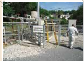
湯けむり発電機
